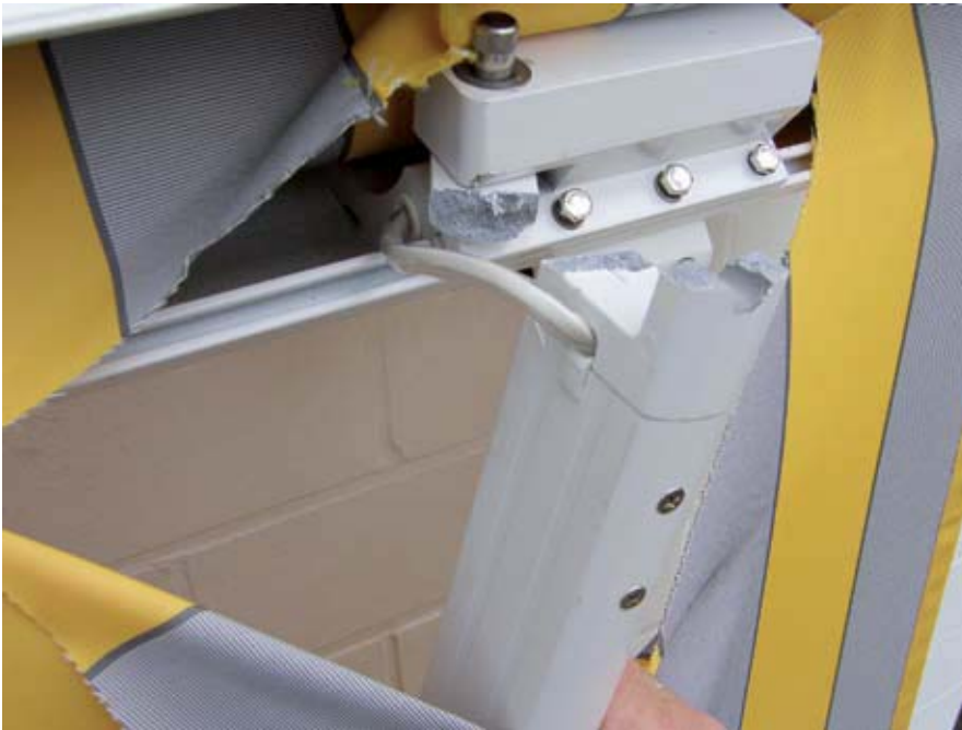
Ursache: Materialbruch in der Gabel des Oberarmgelenks.
